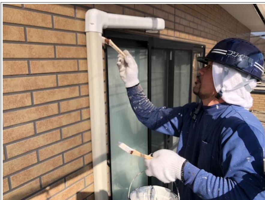
ダクトカバー
