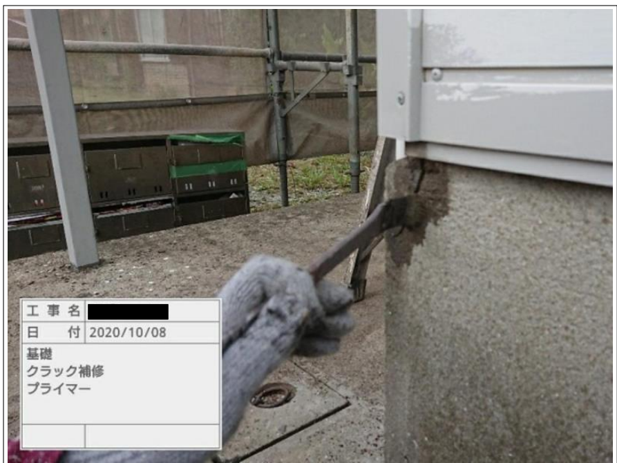
基礎 クラック部
