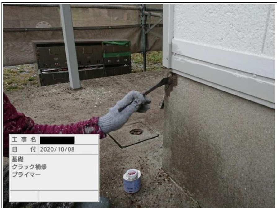
基礎 クラック部
