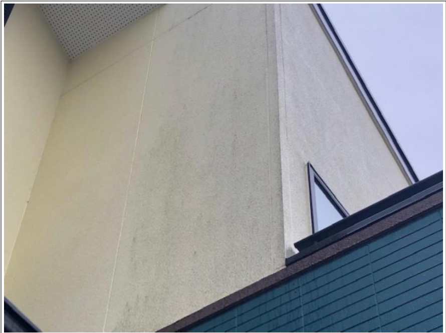
外壁 カビ発生部
