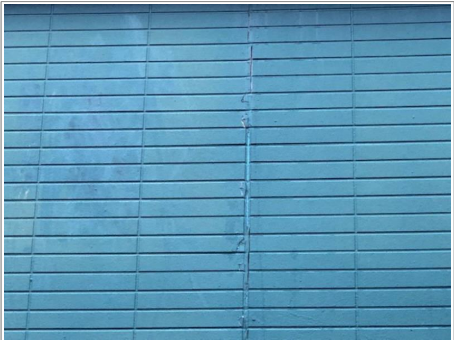
外壁 反り・サイディング割れ
