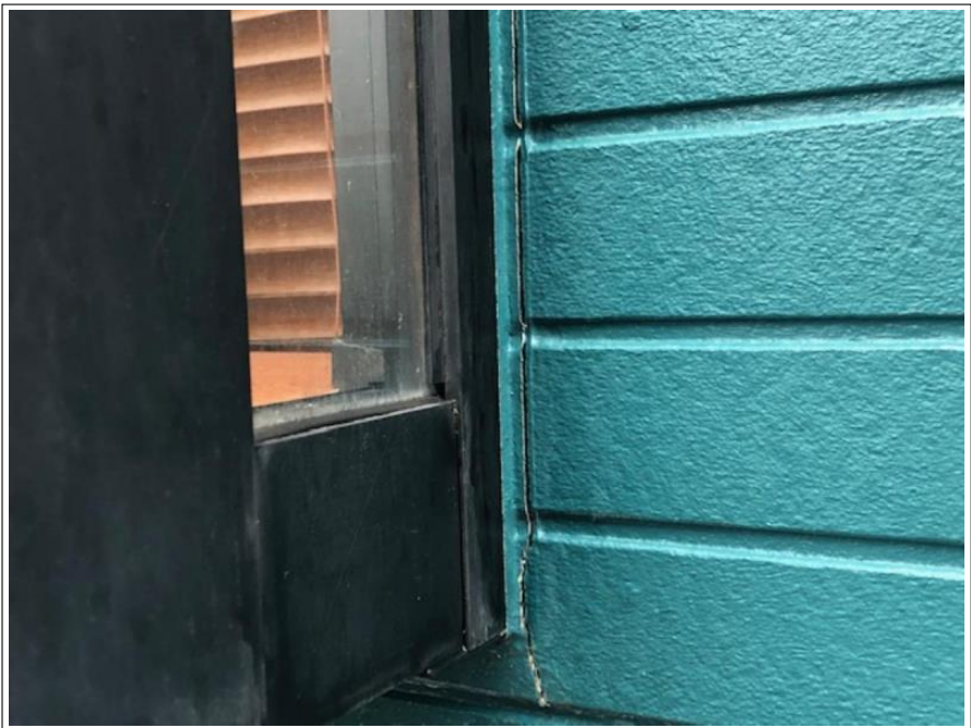
外壁 サッシ廻りシーリング部
