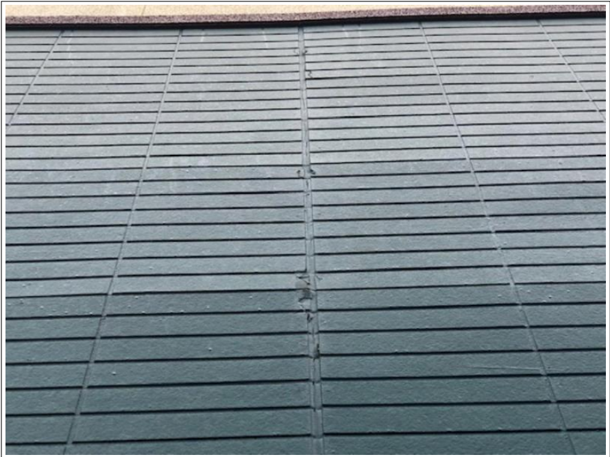
外壁 反り・サイディング割れ
