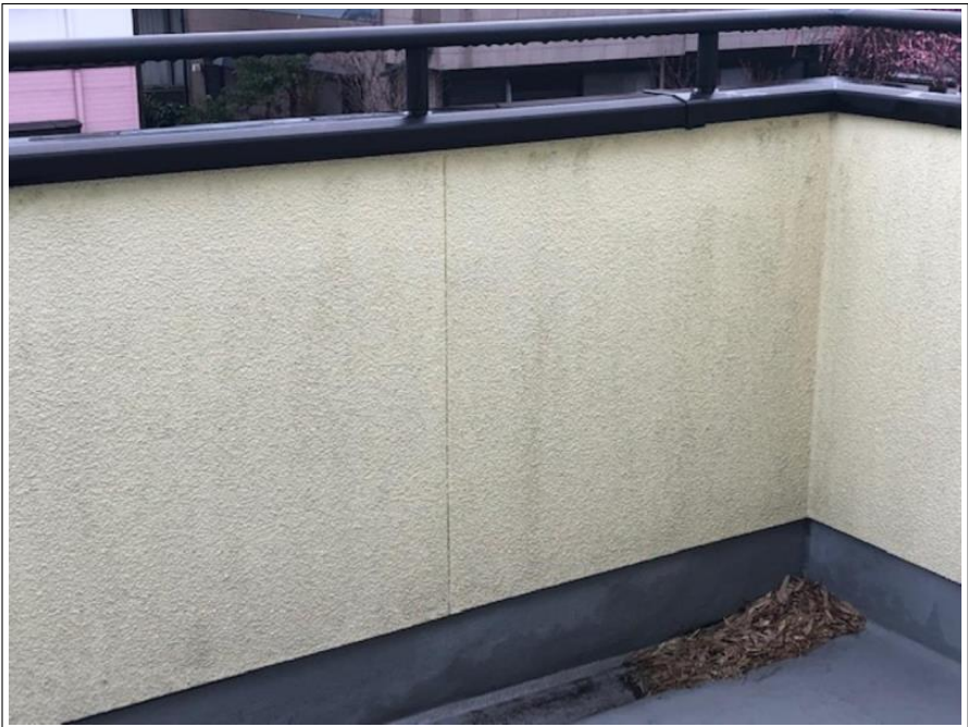
外壁 カビ発生部
