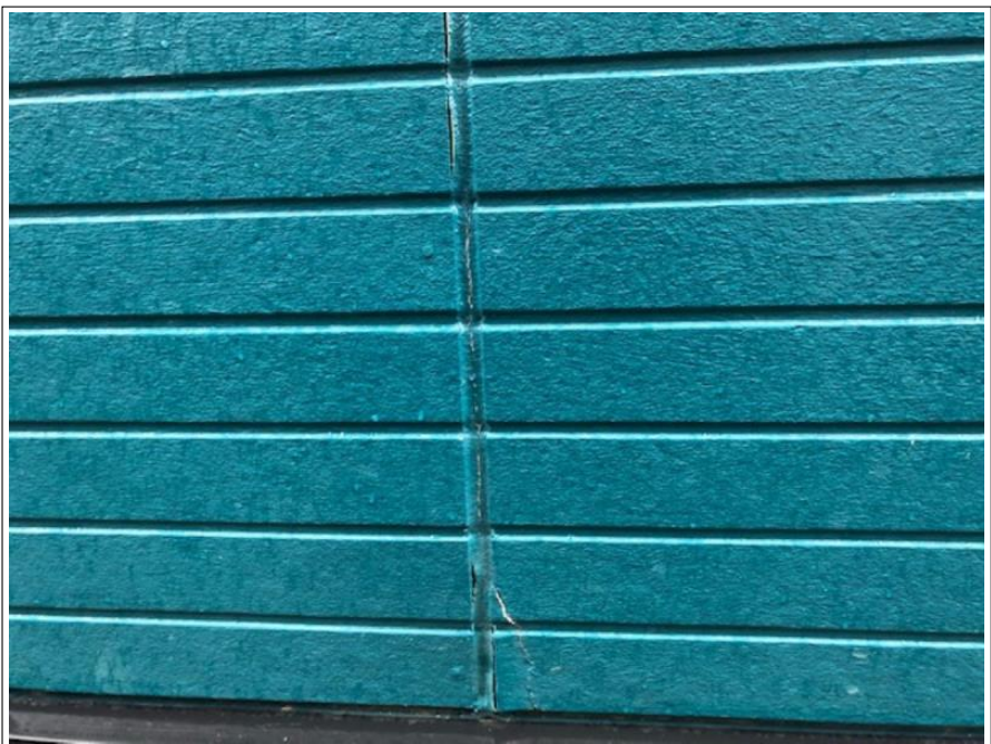
外壁 クラック部
