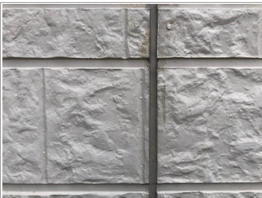
外壁 ボードシーリング劣化部
