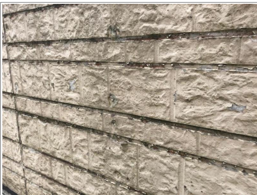
ベランダ 壁 剥離部
