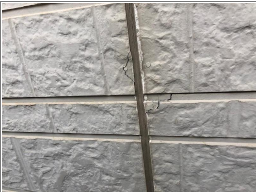
外壁 クラック部
