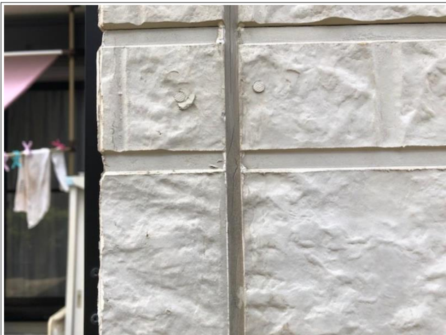
外壁 ボードシーリング劣化部
