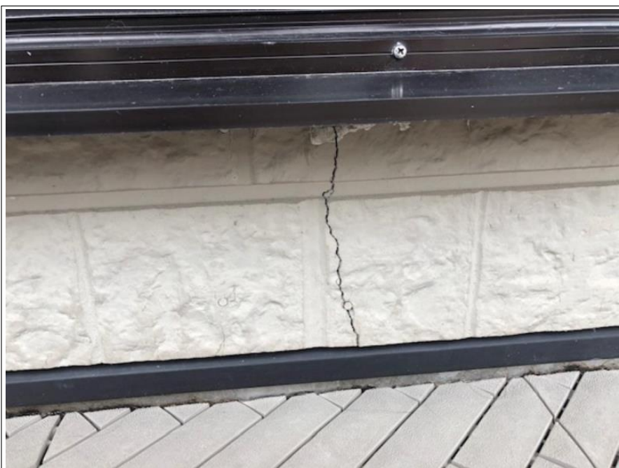
外壁 クラック部
