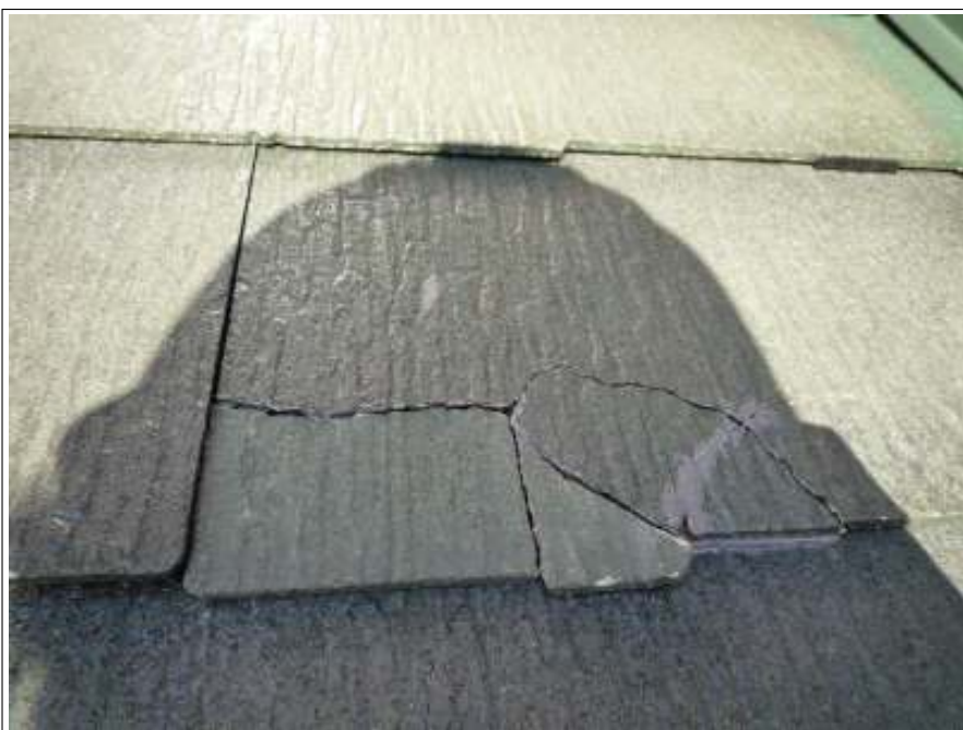
屋根クラック補修施工前
