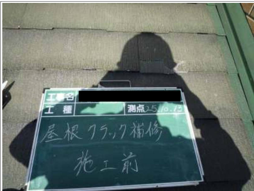
屋根クラック補修施工前
