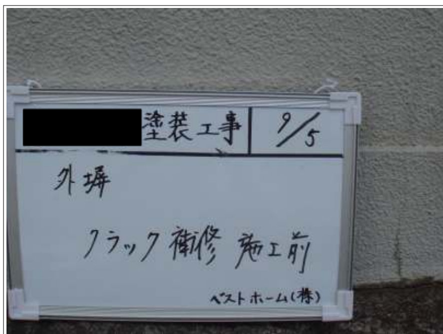
外壁 クラック補修施工前
