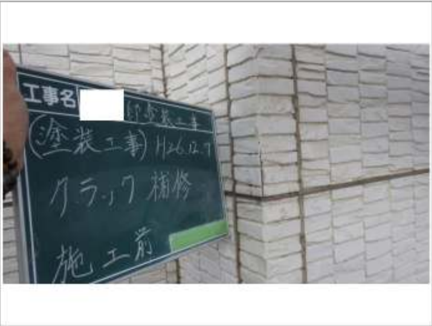
外壁クラック補修施工前
