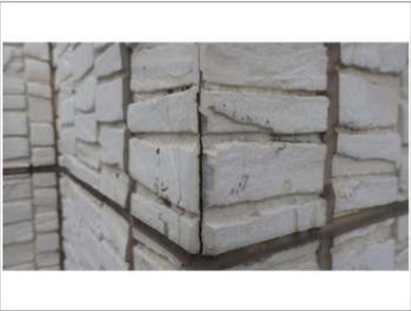
外壁クラック補修施工前
