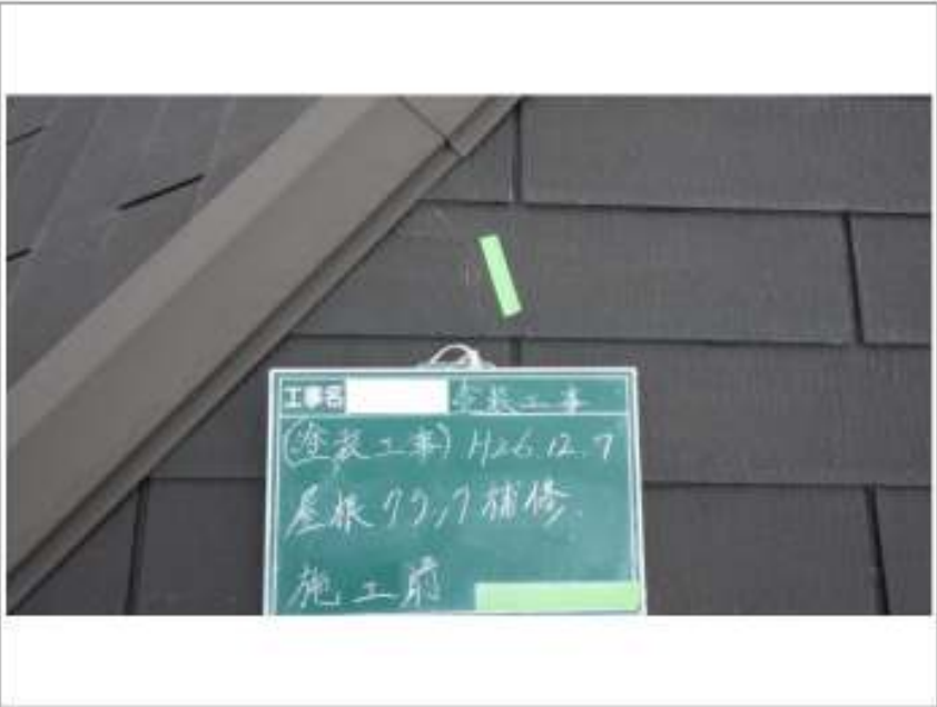
屋根クラック補修施工前
