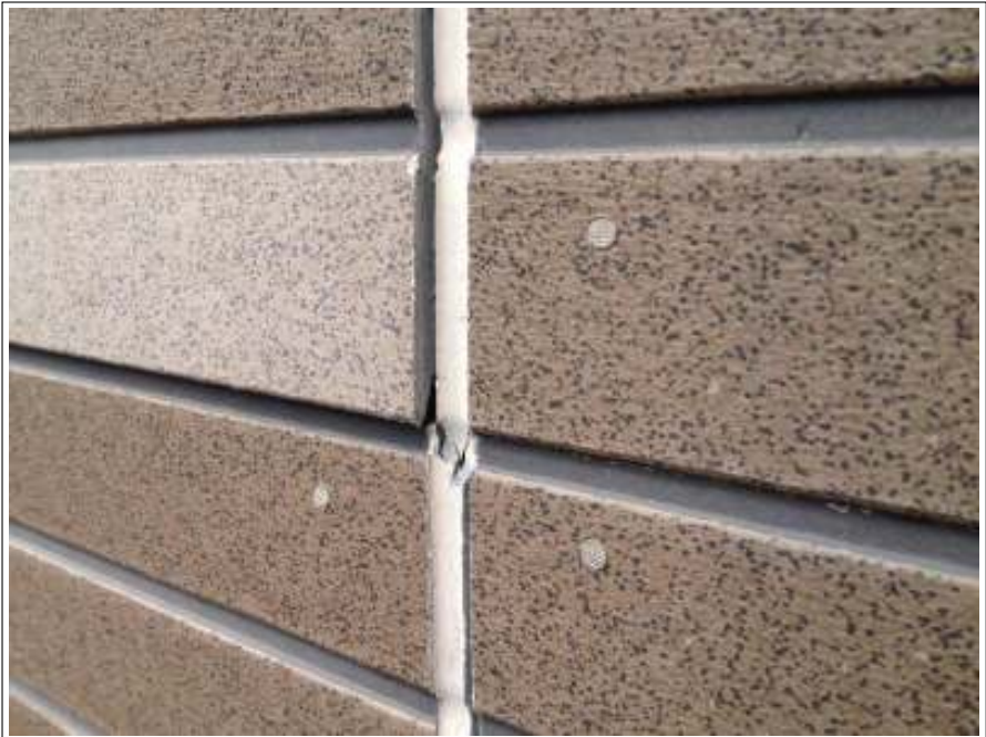
外壁シーリング劣化部
