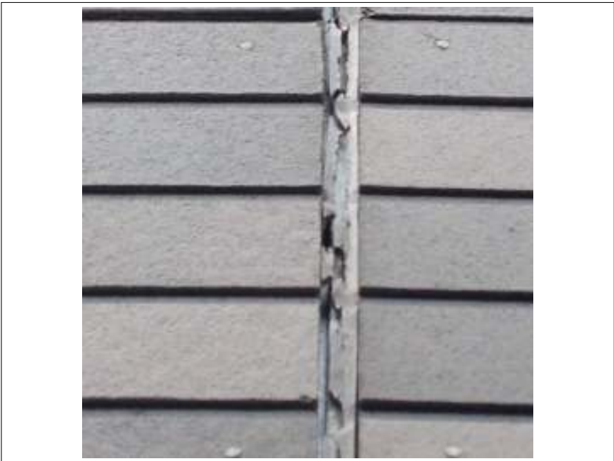
外壁シーリング劣化部
