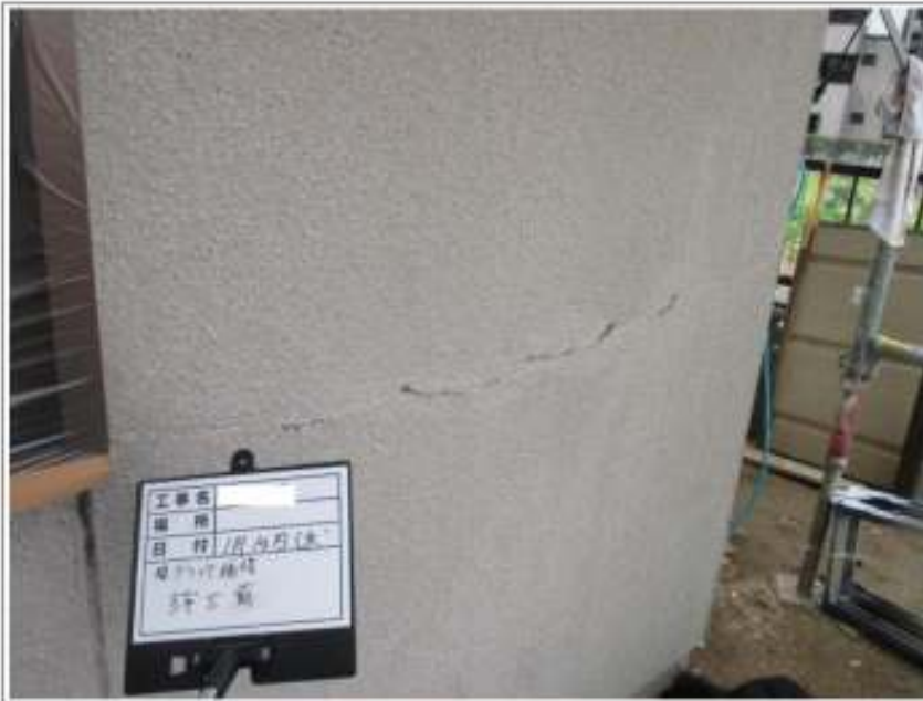
外壁クラック補修施工前
