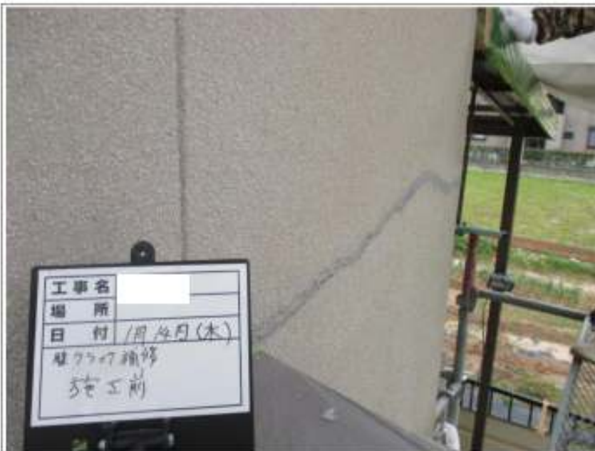
外壁クラック補修施工前
