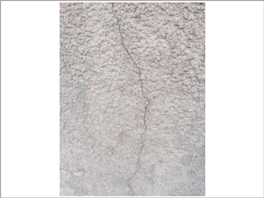
外壁 クラック補修施工前
