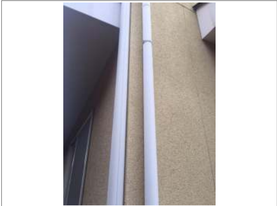
樋・ダクトカバー
