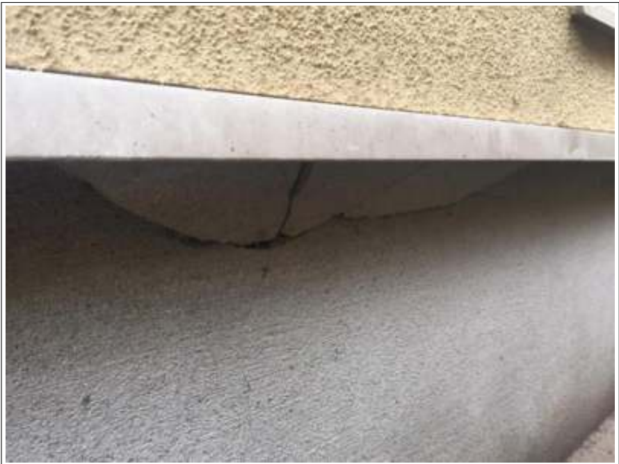
基礎 クラック部
