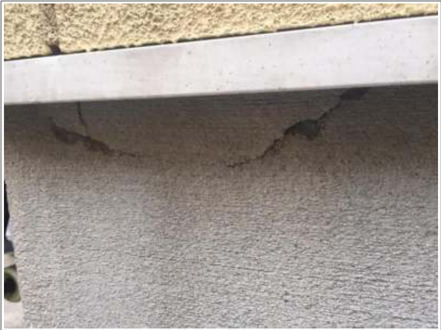
基礎 クラック部
