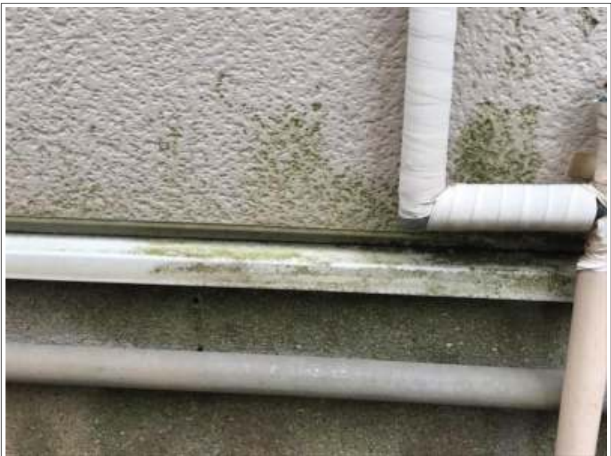
外壁 カビ発生部
