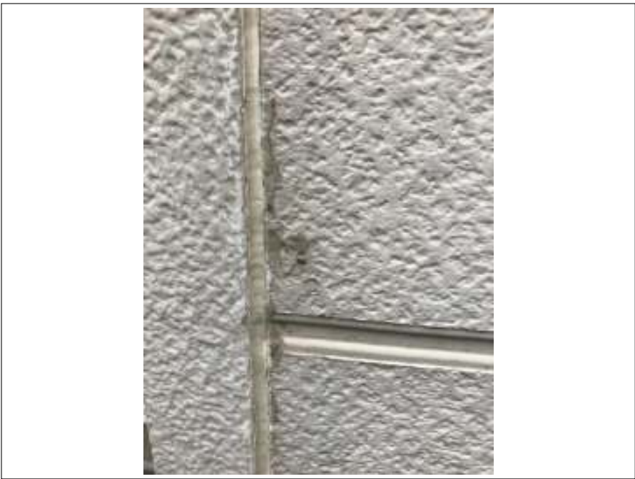
ボードシーリング 劣化部
