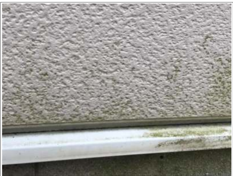
外壁 カビ発生部
