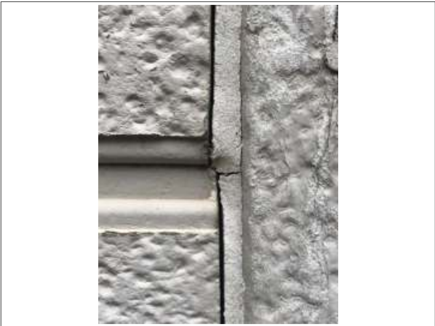
ボードシーリング劣化部
