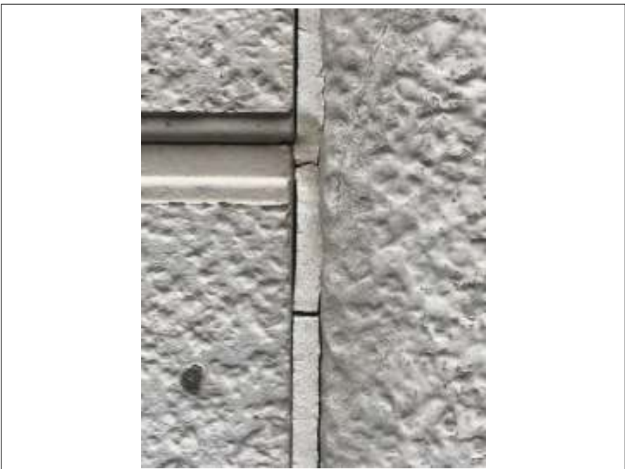
シーリング劣化部
