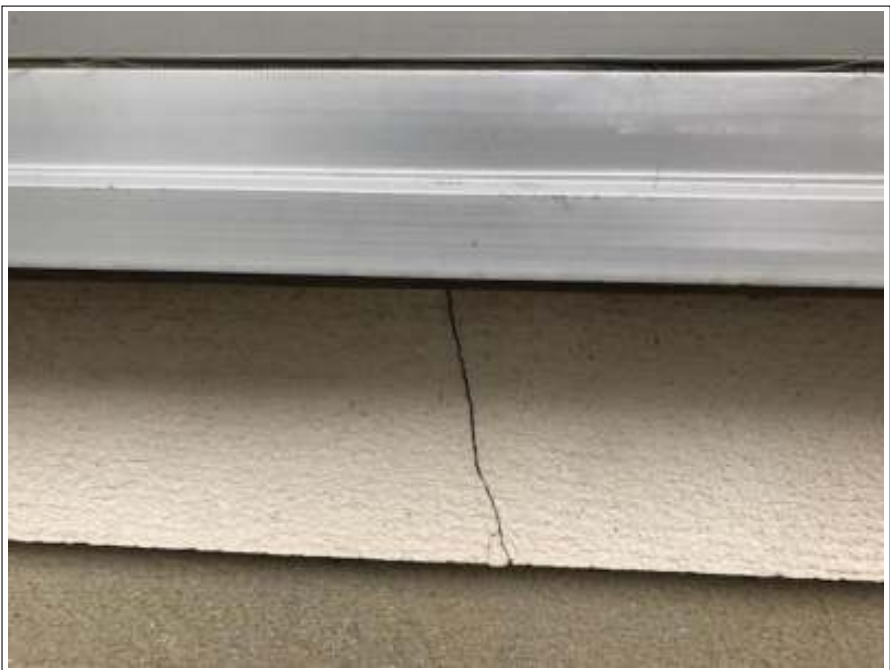
外壁 クラック部
