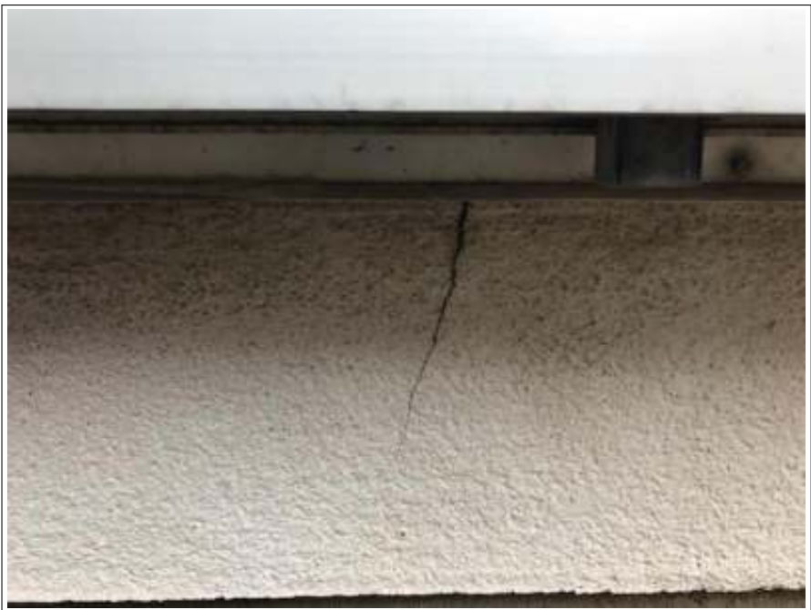
外壁 クラック部
