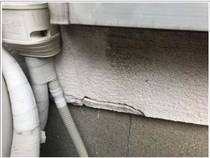
外壁 クラック部
