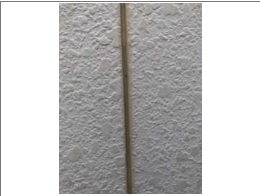
外壁 シーリング劣化部
