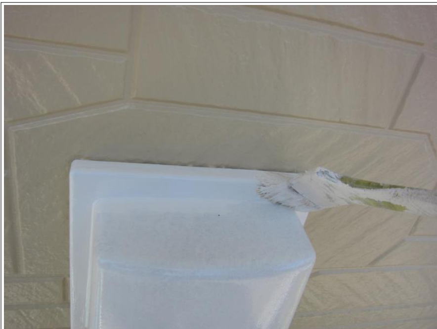
換気フード 塗装
