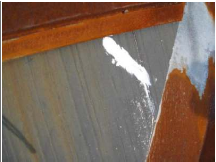
屋根 クラック補修
